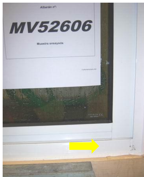
Zona de infiltrações de água
