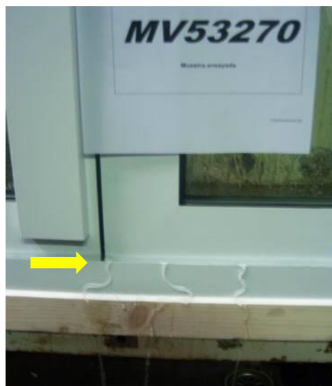
Zona de infiltrações de água
