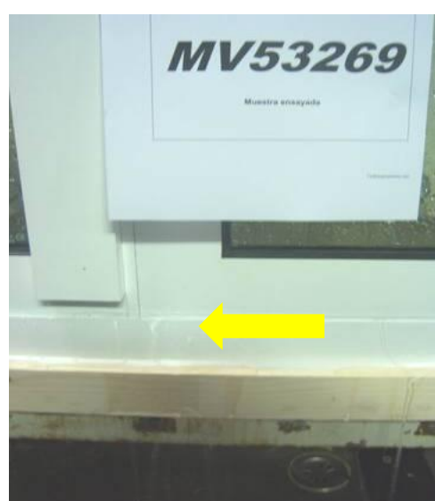
Zona de infiltrações de água
