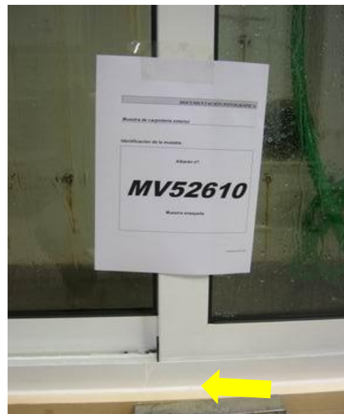
Zona de infiltrações de água
