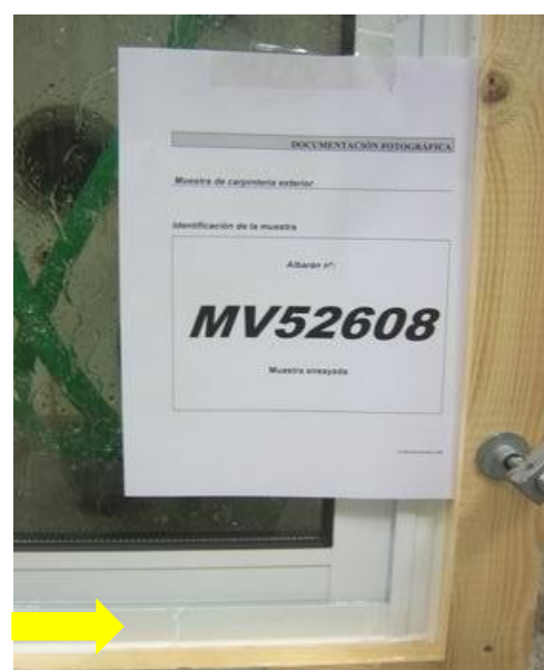
Zona de infiltrações de água
