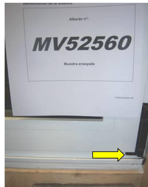
Zona de filtración de água
