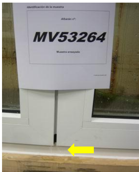
Zona filtración de agua
