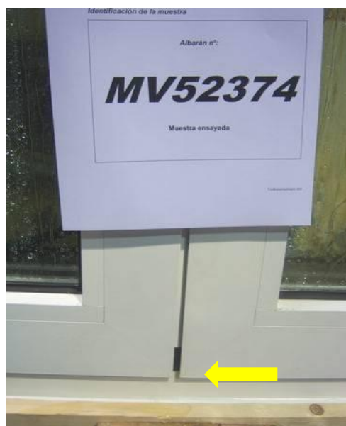
Zona de infiltrações de água
