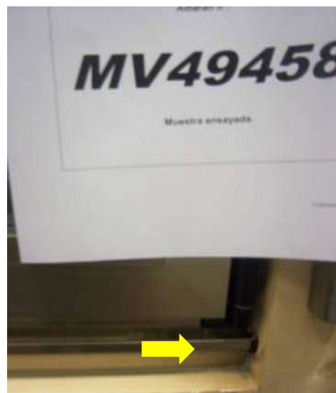
Zona filtración de agua
