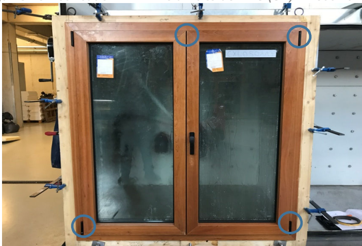
Localização dos pontos onde se identificaram as fugas de ar mais significativas
