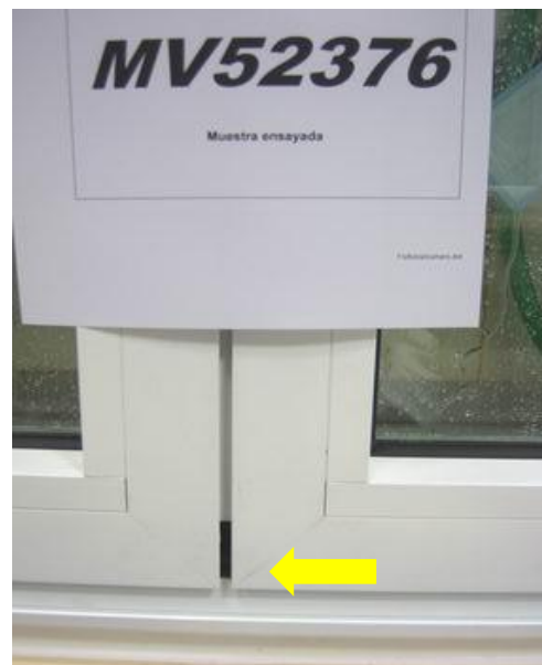
Zona de infiltrações de água
