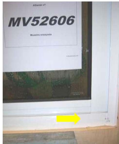
Zona de filtración de agua
