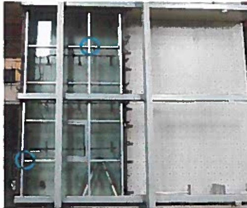
Localização dos pontos onde se identificaram as fugas de ar mais significativas, nos painéis fixos
