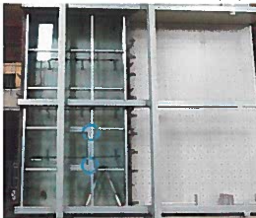
Localização dos pontos onde se identificaram as fugas de ar mais significativas, nos painéis móveis
