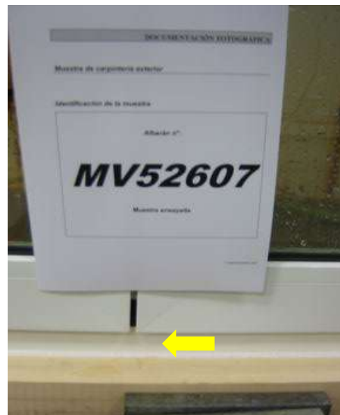
Zona filtración de agua
