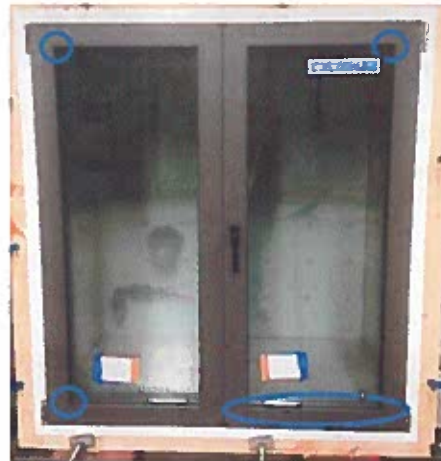
Localização dos pontos onde se identificaram as fugas de ar mais significativas
