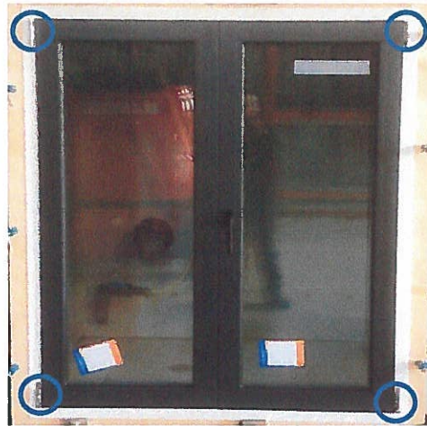
Localização dos pontos onde se identificaram as fugas de ar mais significativas
